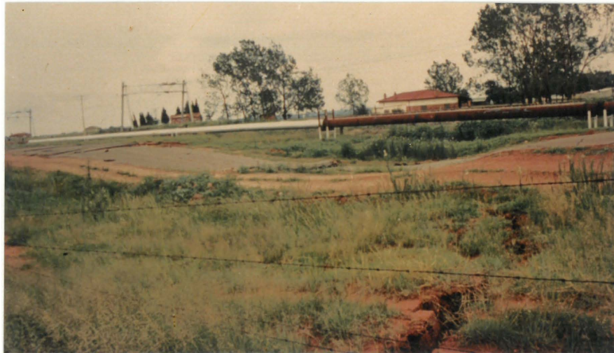
foto 47 HIERDIE 600MM PYPLYN VERVOER GEPOMPTE WATER VANAF VENTERSPOSTMYN OOR 'N AFSTAND VAN 13KM OOR DIE BANKKOMPARTEMENT. LET OP NA DIE KOMPAKSIEVERSAKKING EN PERIFERALE KRAKE.
