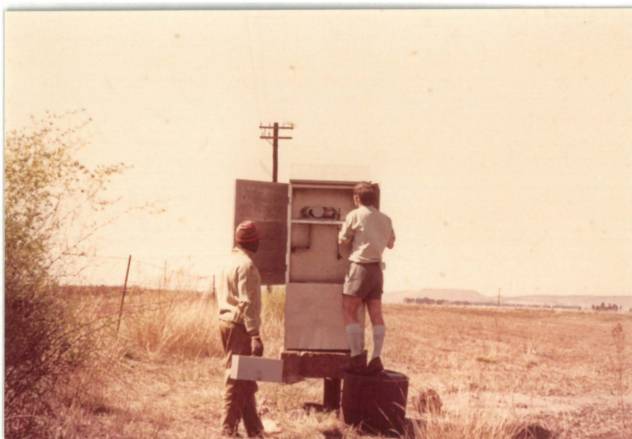
foto 35 MONITOR VAN DIE DOLOMIETWATERVLAK. OPPERVLAKSAKKING IS DIE GEVOLG VAN SAAMPERSING VAN MANGAANAARDE BOKANT DIE BODEMROTS. DIE VOERINGPYP VAN DIE BOORGAT STREK GELEIDELIK HOËR BO GRONDVLAK UIT SOOS KOMPAKSIEVERSAKKING TOENEEM
