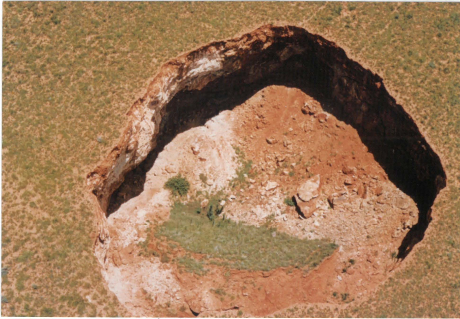
foto 16 'N SINGKAT WAT AS GEVOLG VAN SKILFERING VAN DIE DAK VAN 'N GROT GEVORM HET. DIE LAASTE SKIL TOT OP GRONDVLAK HET AS 'N EENHEID BEHOUE GEBLY.
