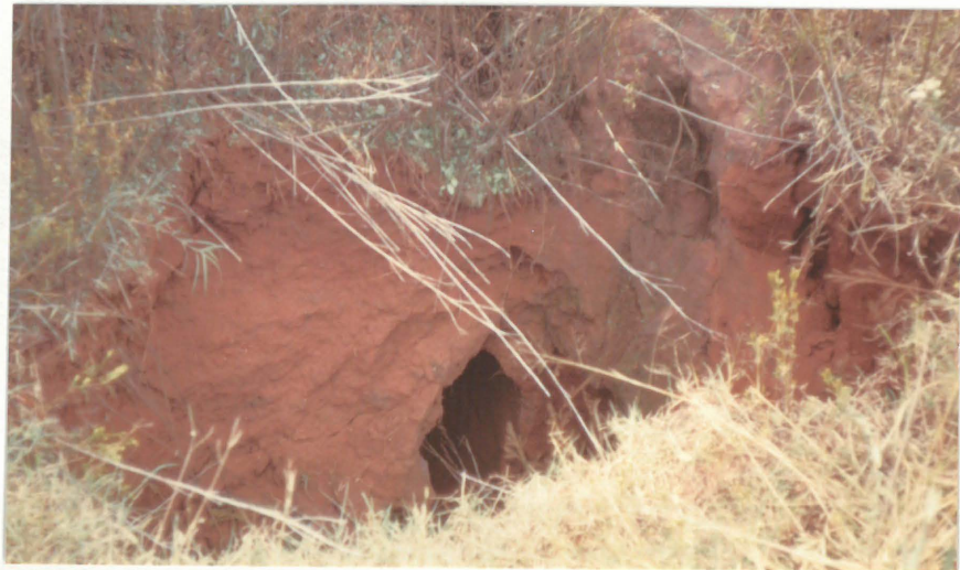
foto 39 EROSIE VAN 'N BOORGAT WAT UITEINDELIK TOT DIE SINGKAT ONDER DIE SPOORLYN OP 9 APRIL 1975 GELEI HET.
