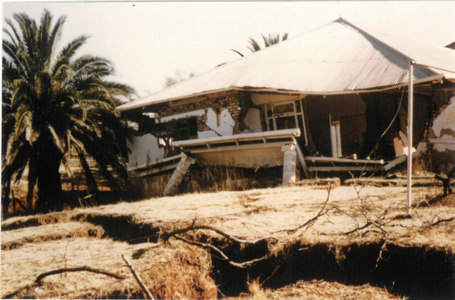
foto 45 VERVALLE WOONHUIS EN SAKKINGSKRAKE 100M NOORD VAN BANKSTASIE.
