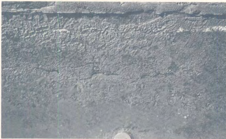
(d) Pumping through longitudinal fatigue crack on Section 2.
