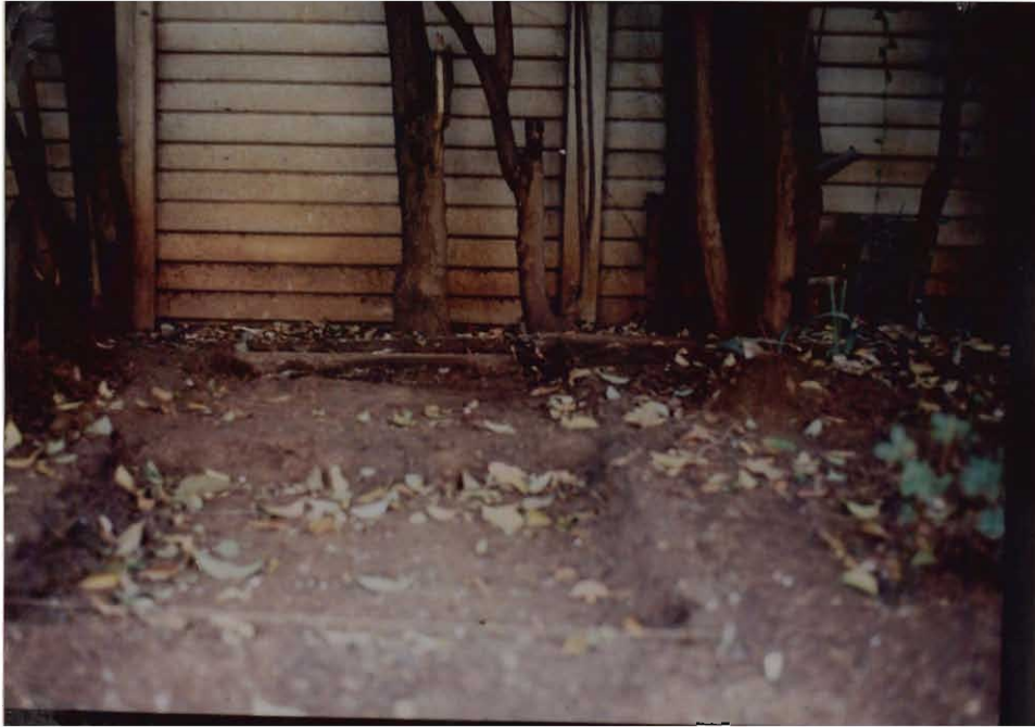
Figuur 7.21 Die voltooide toetsloot 7. Die sement randsteen is sigbaar in die agtergrond.
