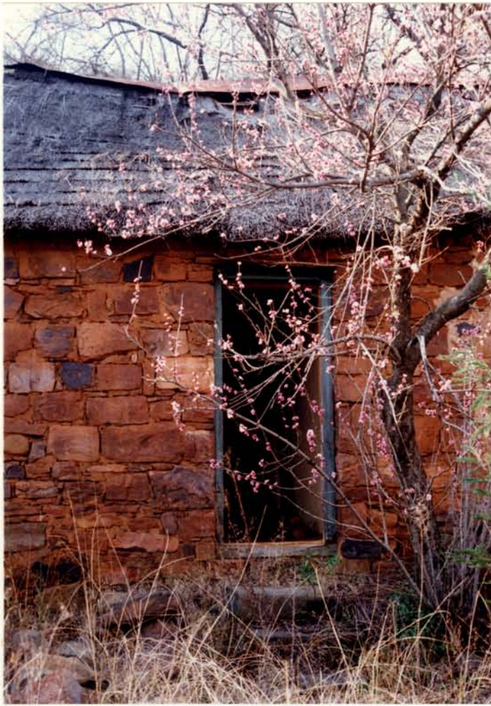
4 Deuropening A, slegs deurraam oor, geen deur nie
