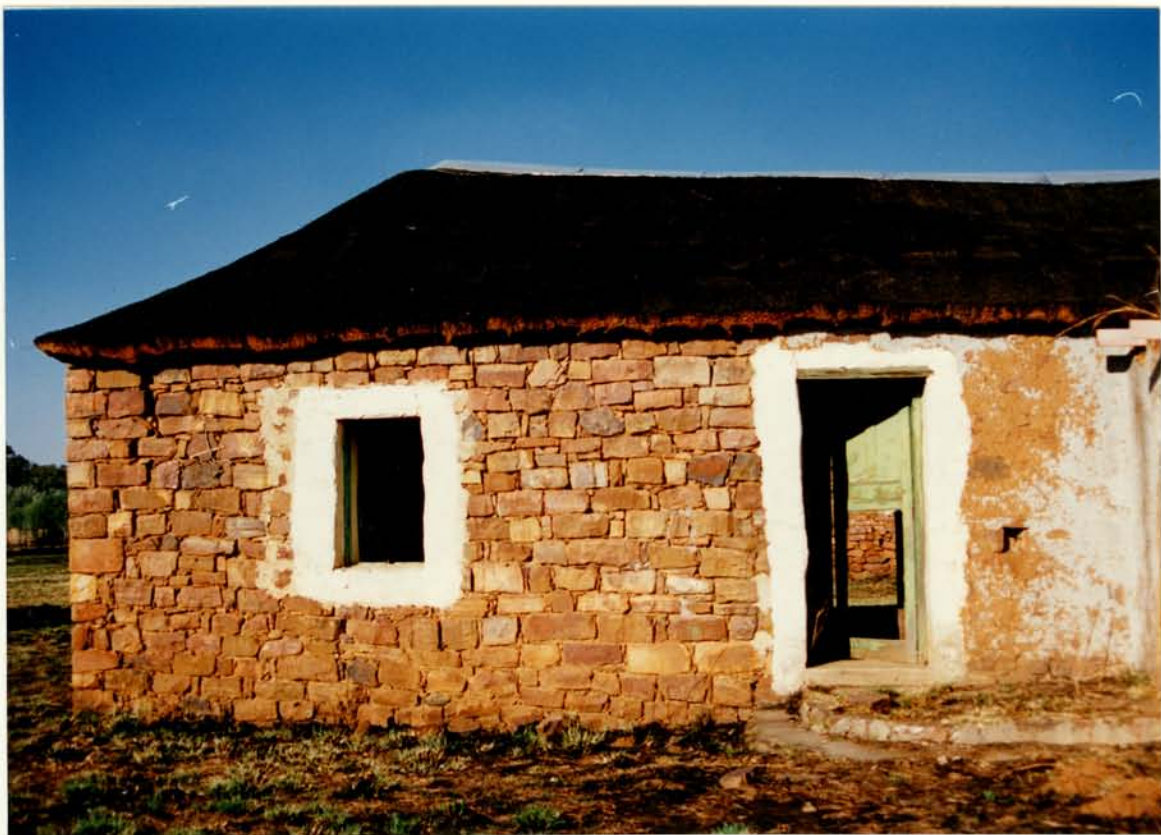
27. Pleisterwerk in hoek van aanbouing Rede onduidelik, is moontlik saam met aanbouing gedoen
