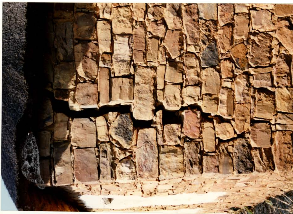
19. Kraak in noordemuur
