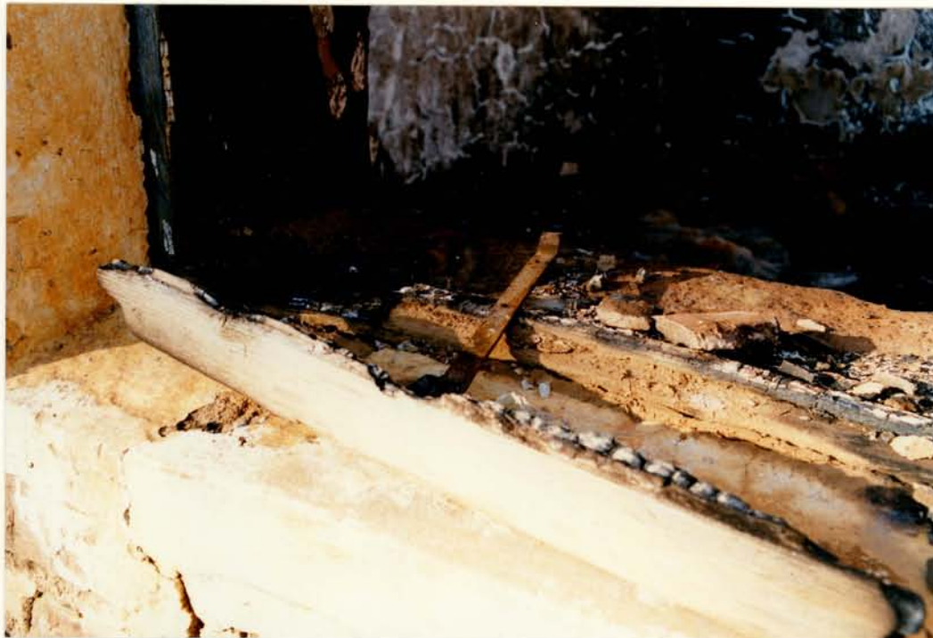
Foto 19.Min vensterbeslag.Vensterrame meestal verbrand.Stukke glas lê rond.
