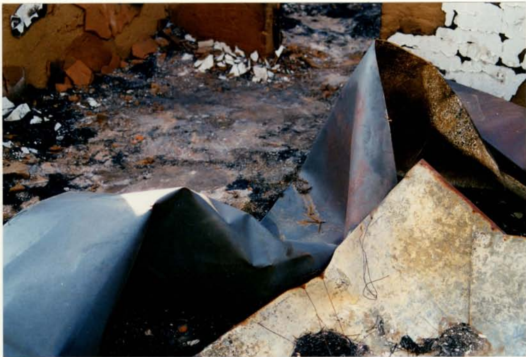
Foto 6. Tekens van dakkonstruksie lê op vloere rond: plaatmetaalnok van grassdak, met stukke binddraad.
