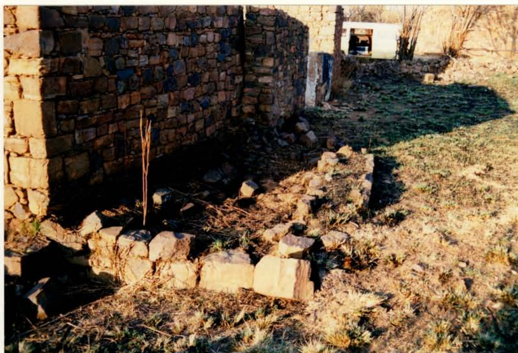
Foto 4. Stoepmuur op suidfasade wat sonder verband as laterale aanbouing toegevoeg is.
