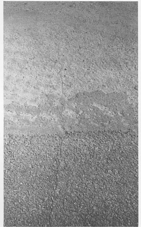
(b) Stabilisation crack.
