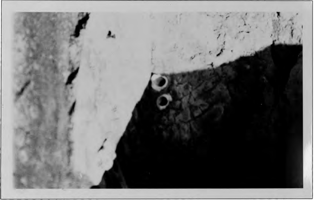
5.8 Die elektriese bedrading is deur porseleinpoortjies soos hierdie, teen die dak van die fort gelei.
